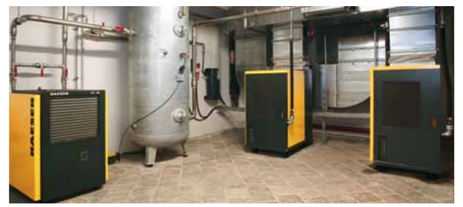
Компрессорная станция Kaeser Kompressoren, размещенная в подвальном помещении
